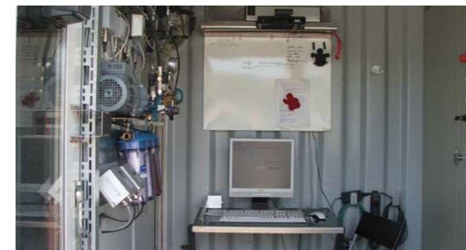
Steuerraum Control room
